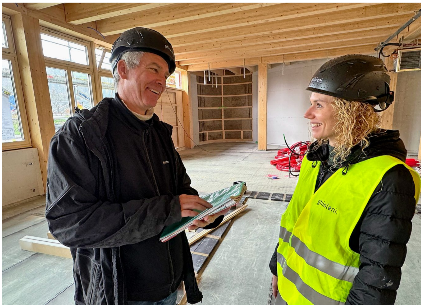
Daraus wird das Lehrzimmer: Die beiden Bauleiter Christoph Deutsch und Tanja Ganic haben gut Lachen. Die Arbeiten verlaufen im Zeitplan.
